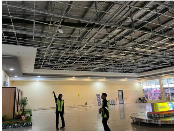
Gambar 4. 9 Kondisi plafon terminal kedatangan
