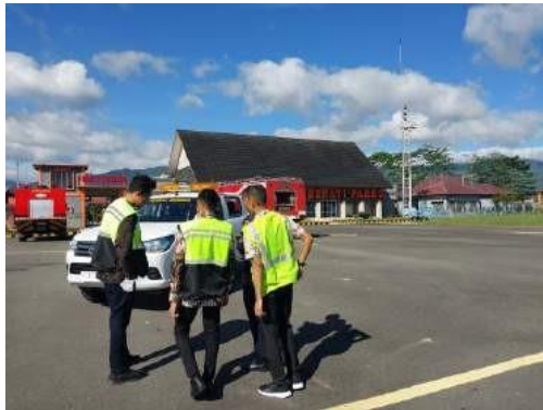
Meninjau kerusakan apron akibat helikopter
