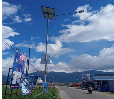
Gambar 4. 31 Tiang Lampu Jalan
