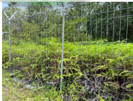
Gambar 4. 10 Kondisi pagar yang berlubang
