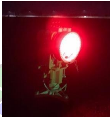
Gambar 2. 13 Stopway Light Sumber: Bandar Udara Internasional Yogyakarta
