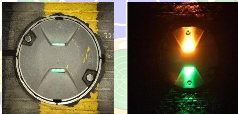
Gambar 2. 11 Taxiway Centerline Light Sumber: Bandar Udara Internasional Yogyakarta
