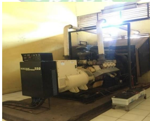
Gambar 2. 5 Genset syncrone 500 kVA
