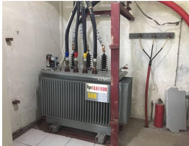
Gambar 2. 11 Tranformator Step Down 500 kVA Sumber : Bandar Udara El-Tari Kupang Th. 2021
