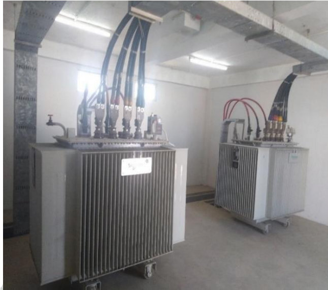
Gambar 2. 7 Tranformator Step Down 1000 kVA Sumber : Bandar Udara El-Tari Kupang Th. 2021
