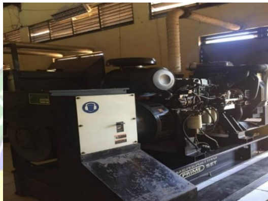
Gambar 2. 6 Genset 250 kVA Sumber : Bandar Udara El-Tari Kupang Th. 2021
