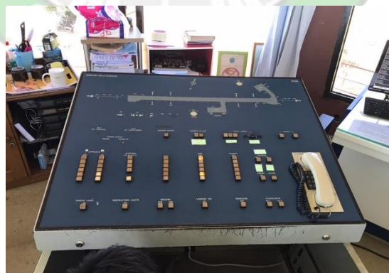
Gambar 2. 24 Control Desk Sumber : Bandar Udara El-Tari Kupang Th. 2021
