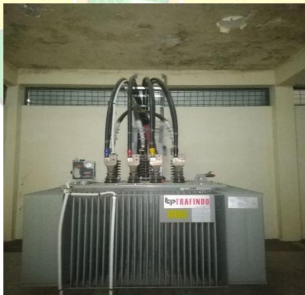
Gambar 2. 8 Tranformator Step Down 800 kVA Sumber : Bandar Udara El-Tari Kupang Th. 2021
