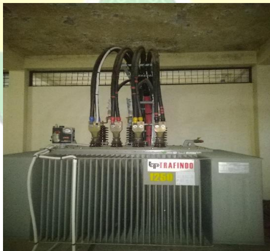
Gambar 2. 10 Tranformator Trafindo Step Up 1250 kVA Sumber : Bandar Udara El-Tari Kupang Th. 2021
