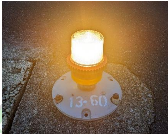
Gambar 3.6 Lampu Tipe Elevated Sumber : PT.Bandara Hang Nadim
