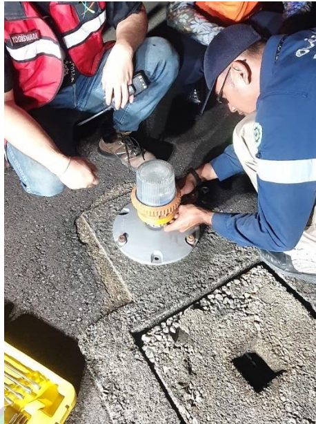
Gambar 4.1 Lampu Runway Edge yang akan diganti Sumber : PT Bandara Internasional Batam
