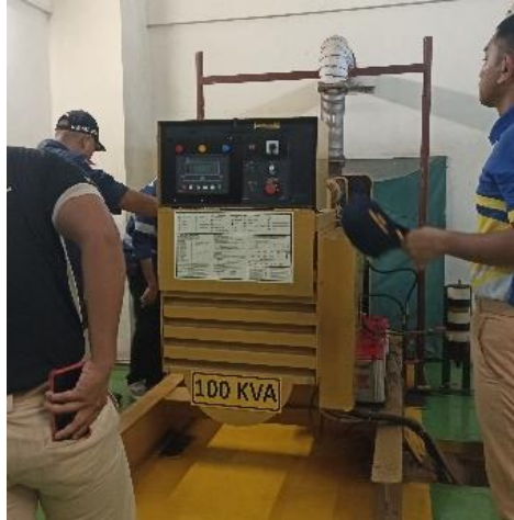
Gambar 2.8 Genset SS2 Sumber: PT Bandara Internasional Batam
