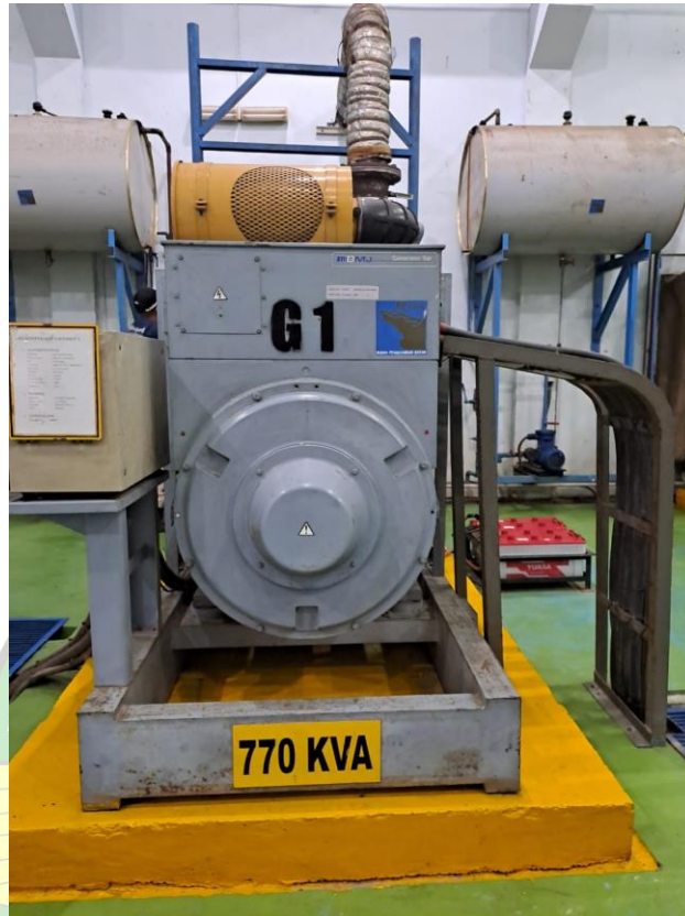
Gambar 2.3 Genset 1 Sumber: PT Bandara Internasional Batam
