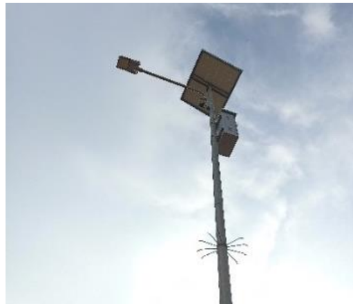
Gambar 2.13 PJU Parameter Solar Cell Sumber: PT Bandara Internasional Batam
