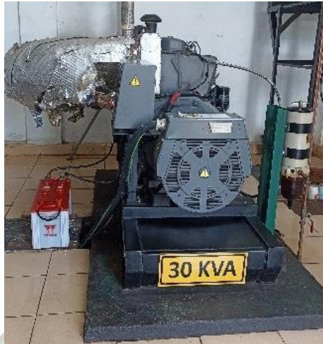
Gambar 2.7 Genset DVOR Sumber: PT Bandara Internasional Batam
