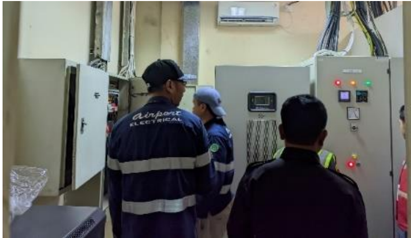
Gambar 2.12 UPS Terminal Sumber: PT Bandara Internasional Batam
