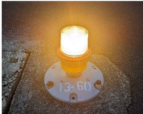
Gambar 2.16 Lampu Runway Edge Sumber: PT. Bandara Internasional Batam
