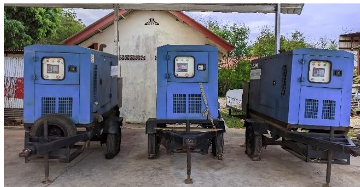
Gambar 2.9 Genset Portable Sumber: PT Bandara Internasional Batam
