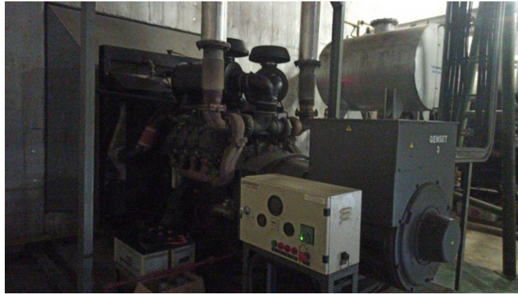
Gambar 2. 19 Genset 3 Sumber : Dokumentasi Penulis
