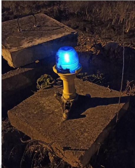
Gambar 2. 29 Taxiway Edge Light Sumber : Dokumentasi Penulis
