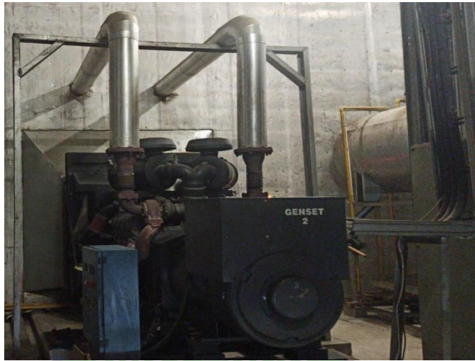
Gambar 2. 18 Genset 2 Sumber : Dokumentasi Penulis
