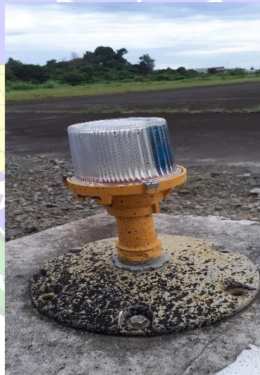
Gambar 2. 25 Elevated Threshold Light Sumber : Dokumentasi Penulis
