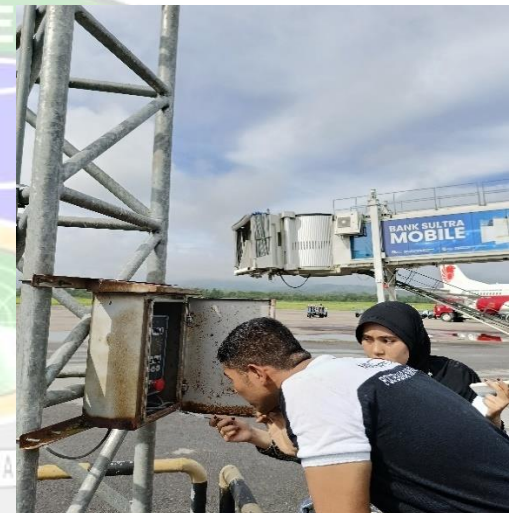
Pengecekan KWH Area Apron
