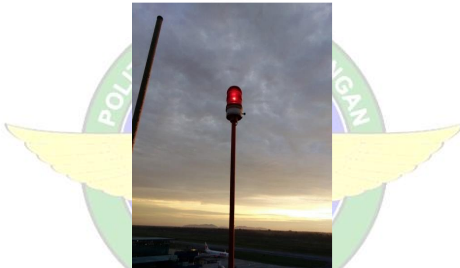
Gambar 2. 32 Obstruction Light Sumber : Dokumentasi Penulis
