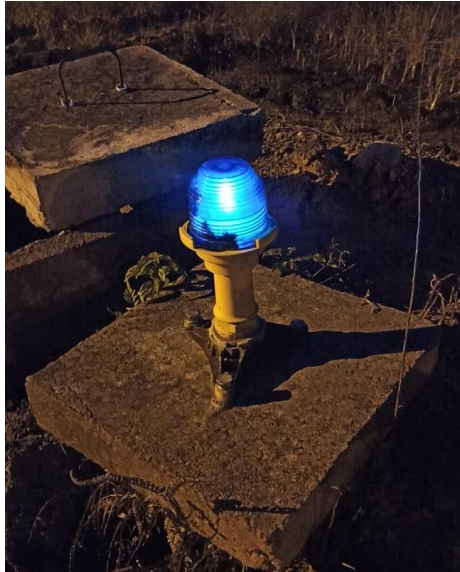
Gambar 2. 29 Taxiway Edge Light Sumber : Dokumentasi Penulis
