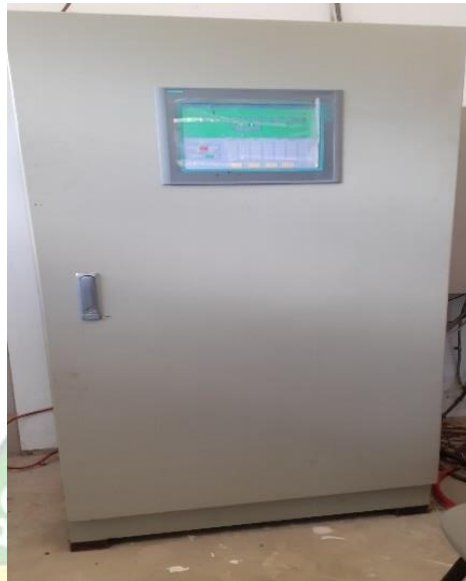
Gambar 2. 34 Control Desk Sumber : Dokumentasi Penulis
