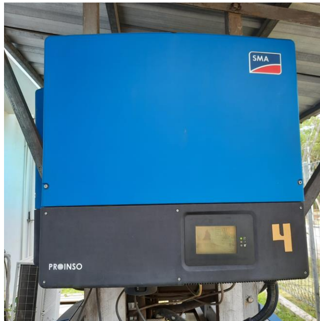
Gambar 4. 2 Inverter Sumber : Dokumentasi Penulis
