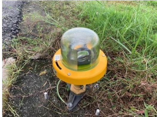
Gambar 2. 5 Lampu Runway Edge Light Sumber: Bandar Udara Internasional Supadio Pontianak
