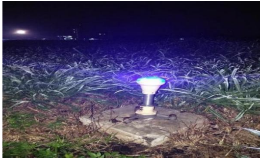
Gambar 2. 11 Taxiway Edge Light Sumber : Bandara Husein Sastranegara
