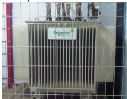
Gambar 2. 29 Fisik Transformator 630 KVA (Step Down)
