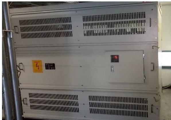
Gambar 2. 30 Transformator 2000 KVA Sumber : Bandara Internasional Husein Sastranegara
