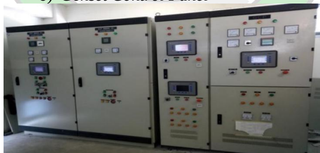
Gambar 2. 26 Fisik Genset Control Panel Sumber : Bandara Husein Sastranegara
