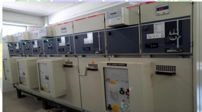
Gambar 2. 27 Fisik Cubicle Sumber : Bandara Husein Sastranegara
