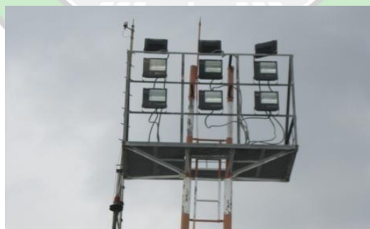
Gambar 2. 22 Apron Floodlight Sumber : Bandara Husein Sastranegara
