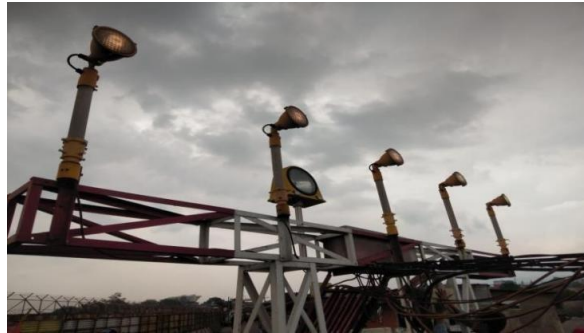
Gambar 2.3 Approach Light Sumber: Bandara Husein Sastranegara Bandung
