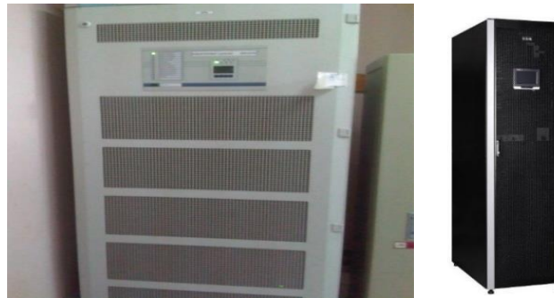
Gambar 2. 28 Fisik Panel Modul UPS 120 kVA & 125 kVA
