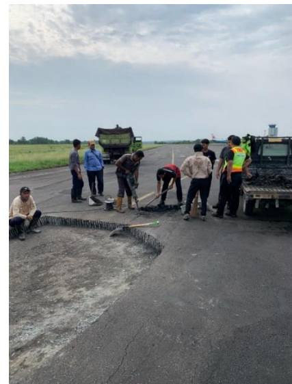
Melakukan pengawasan Bersama Supervisor AMC saat memperbaiki Apron yang rusak
