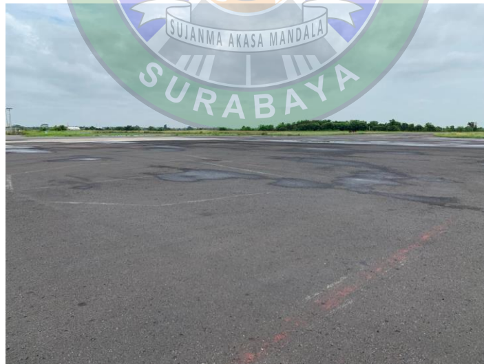
Gambar 4.2 Kondisi Marka Apron yang mulai memudar
