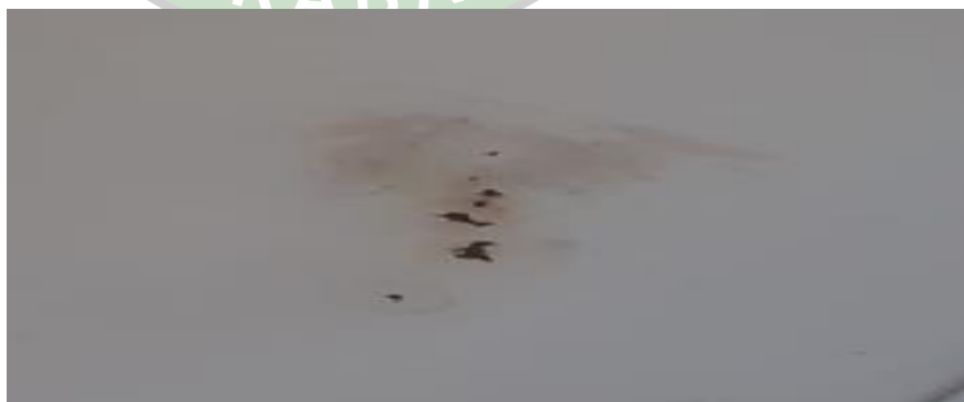
Gambar 4. 17 Plafon Rusak di Area Ruang Tunggu
