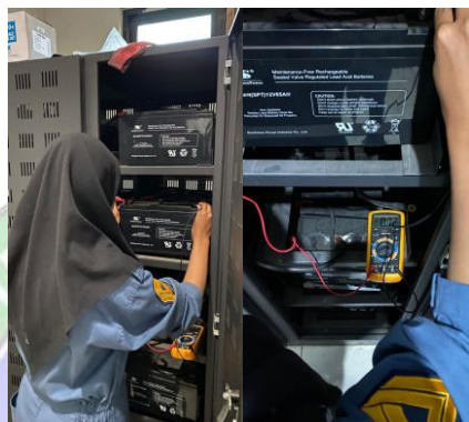
Gambar 4. 1 Uji Baterai UPS
