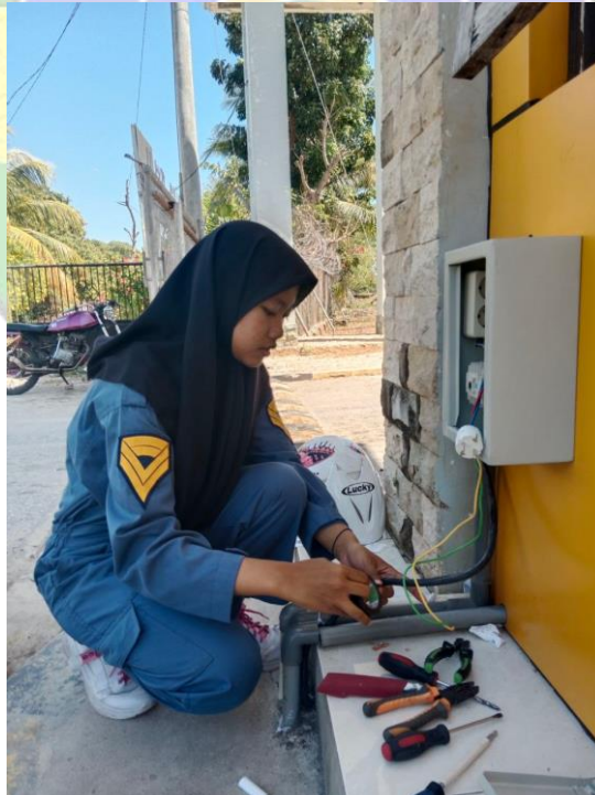
Gambar 5. 2 Instalasi Panel untuk lampu Mandiri
