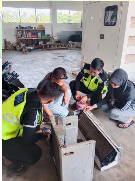
Gambar 5. 4 Pengecekan AC di Power House
