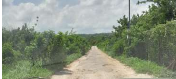
Gambar 4. 6 Akses jalan patroli pagar Parimeter berlubang dan rusak
