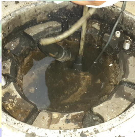
Gambar 4.1 Genangan Air Pada Instalasi Lampu Insert
