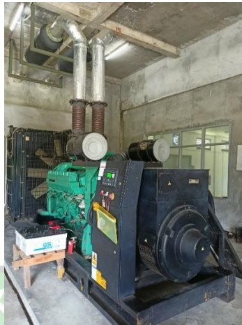
Gambar 2. 18 Genset 1000 KVA (Stamford)
