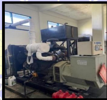
Gambar 2. 9 fisik genset 150 kVA
