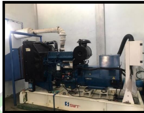
Gambar 2. 10 fisik genset 250 kVA
