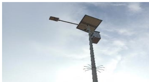
Gambar 2. 21 PJU Parameter Solar Cell Sumber: PT Bandara Internasional Batam
