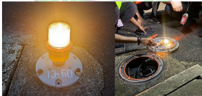
Gambar 2. 5 Lampu Runway Edge Sumber: PT. Bandara Internasional Batam
