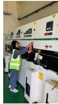
Perawatan Rutin Cubicle di Ruang Trafo Baru
