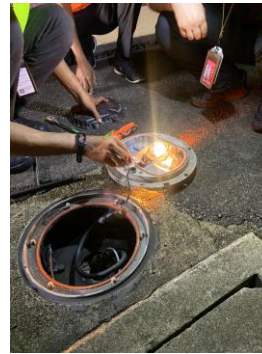
Perawatan Lampu runway edge insert di runway 04
