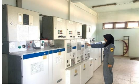
Gambar 2. 9 Catu Daya PLN Sumber: PT Bandara Internasional Batam
