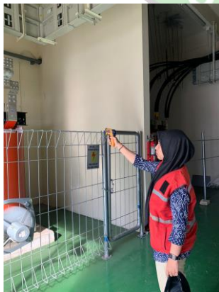
Pengecekan Suhu Trafo Baru
