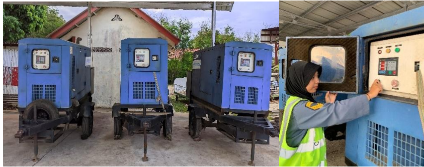
Gambar 2. 17 Genset Portable Sumber: PT Bandara Internasional Batam
