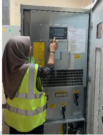
Gambar 2. 20 UPS Terminal Sumber: PT Bandara Internasional Batam
