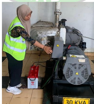
Gambar 2. 15 Genset DVOR Sumber: PT Bandara Internasional Batam
