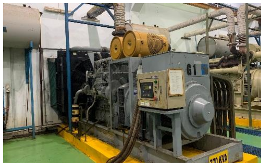
Gambar 2. 11 Genset 1 Sumber: PT Bandara Internasional Batam
