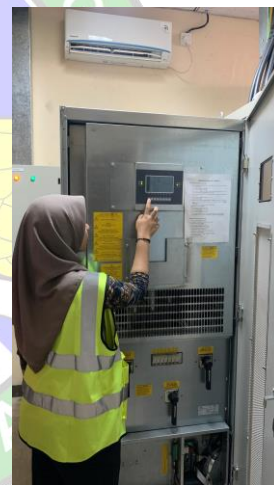
Pemeliharaan UPS Terminal
