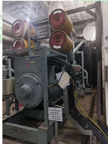
Gambar 4.13 Genset 2000 kVA Sumber : Dokumentasi Pribadi
