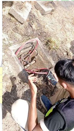
Pengecekan Arus Taxiway Edge Light
