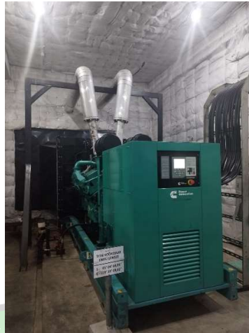
Gambar 4.14 Genset 1000 kVA Sumber : Dokumentasi Pribadi
