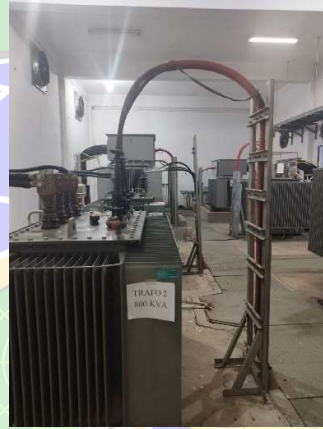
Gambar 4.16 Transformator Sumber : Dokumentasi Pribadi
