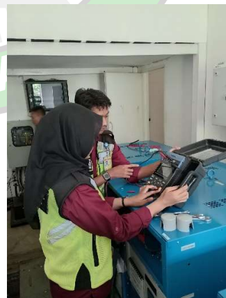
Pengukuran Tahanan Isolasi Runway Edge Light Cct. 2 Looping
