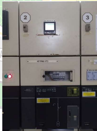
Gambar 4.19 Panel Metering Sumber : Dokumentasi Pribadi
