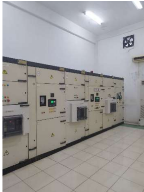
Gambar 4.18 Panel Kontrol Genset Sumber : Dokumentasi Pribadi
