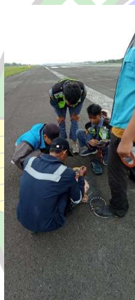
Pengecekan Arus Runway Edge Light
