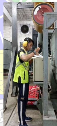
Monitoring Genset 2000 kVA
