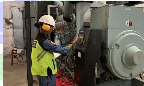
Monitoring Genset 2000 kVA
