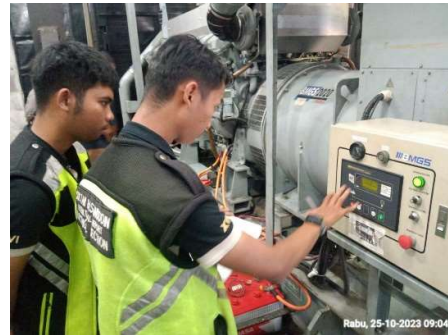
Monitoring Genset 2000 kVA
