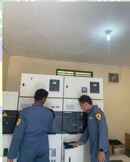
Perawatan Cubicle 20 KV
