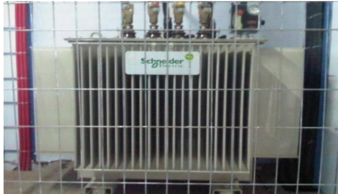
Gambar 2. 30 Fisik Transformator 630 KVA (Step Down) Sumber: Bandara Husein Sastranegara
