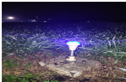
Gambar 2. 10 Taxiway Edge Light Sumber: Bandara Internasional Husein Sastranegara
