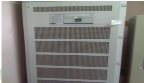
Gambar 2. 37 Fisik Panel Modul UPS 120 KVA Sumber: Bandara Internasional Husein Sastranegara
