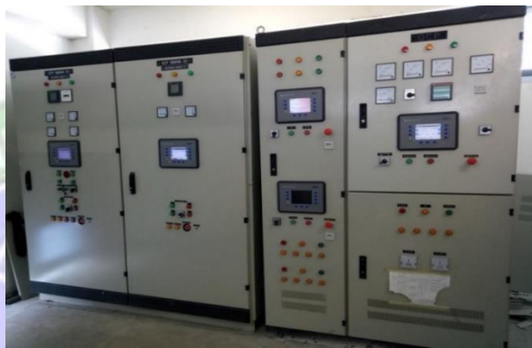
Gambar 2. 32 Fisik Genset Control Panel Sumber: Bandara Husein Sastranegara
