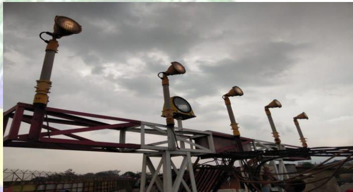
Gambar 2. 1 Approach Light Sumber : Bandara Internasional Husein Sastranegara
