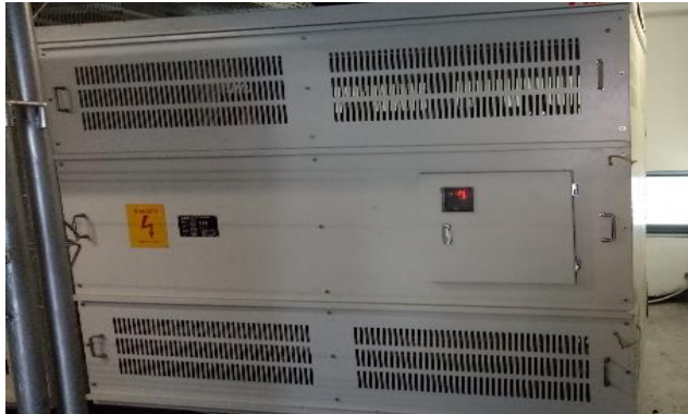
Gambar 2. 31 Transformator 2000 KVA Sumber: Bandara Husein Sastranegara
