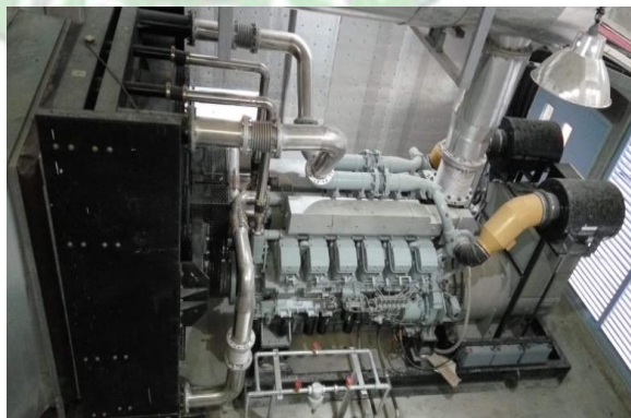
Gambar 2. 35 Fisik Genset 1500 KVA
