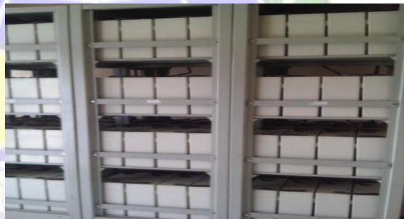
Gambar 2. 38 Fisik Battery Rack UPS 120 KVA Sumber: Bandara Internasional Husein Sastranegara
