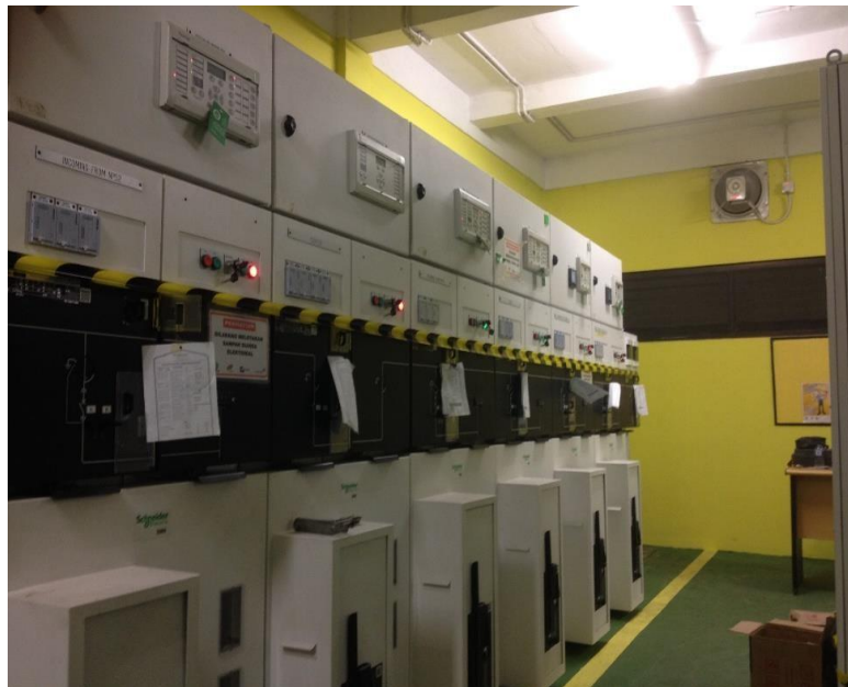
Gambar 2. 39 Panel Tegangan Menengah di Gardu NP52 Sumber: Penulis
