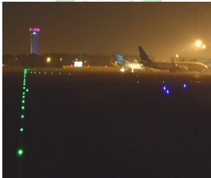
Gambar 2. 19 Taxiway Centerline Light Sumber: Penulis
