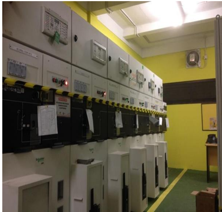
Gambar 2. 35 Panel Kubikel 20KV Sumber: Penulis
