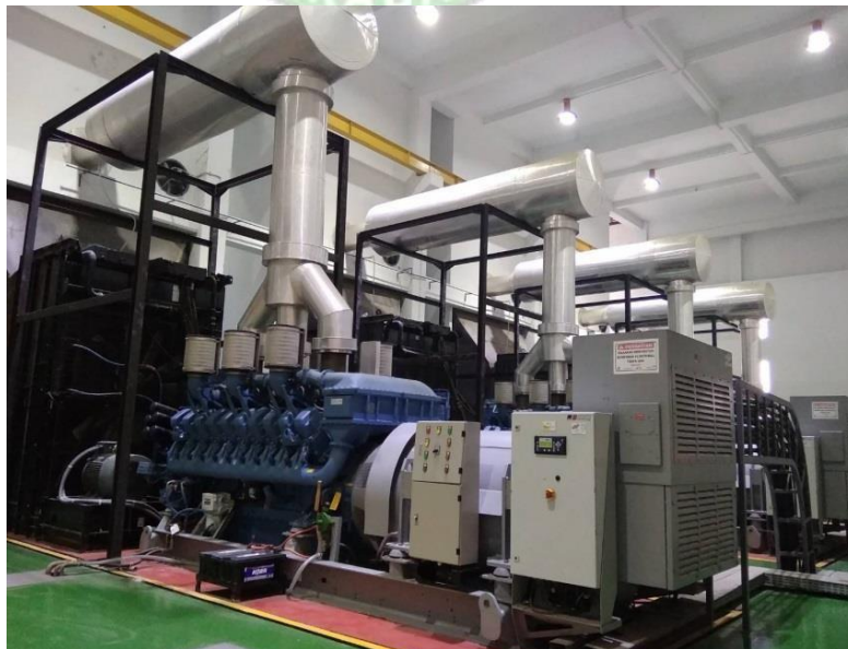
Gambar 2. 31 Genset Gedung MPS 2 Sumber: Penulis
