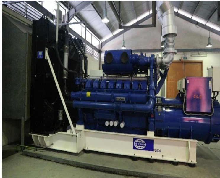
Gambar 2. 30 Genset Gedung MPS 1 (Baru) Sumber: Penulis
