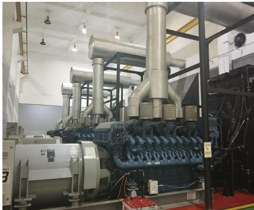
Gambar 2. 32 Genset Gedung MPS 3 Sumber: Penulis
