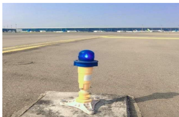
Gambar 4. 15 Lampu Taxiway Edge sudah menyala
