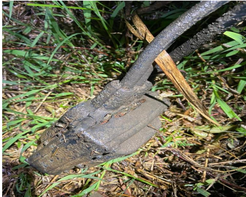
Gambar 4. 5 Penemuan trafo rusak di area SC 6
