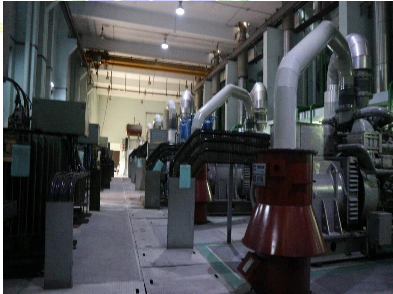
Gambar 2. 29 Genset Stand by Gedung MPS 1 (Lama) Sumber: Penulis
