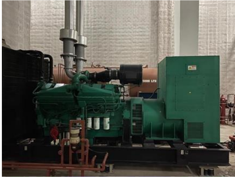
Gambar 2. 31 Genset 1000kVA Sumber: Dokumentasi Penulis, 2023
