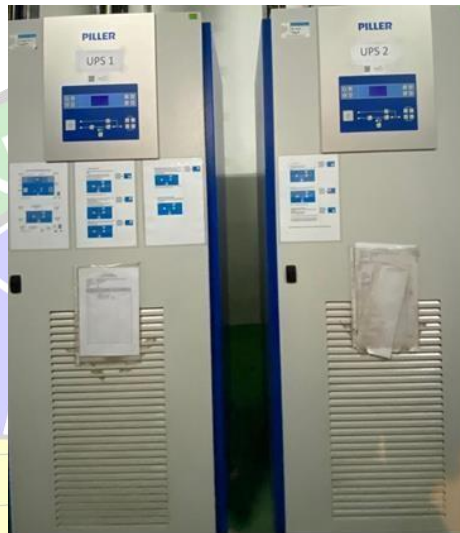
Gambar 2. 35 UPS 100 kVA Sumber: Dokumentasi Penulis, 2023
