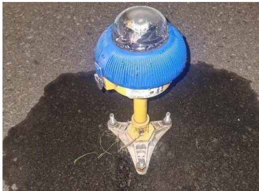
Gambar 2. 20 Turning Area Lighting Sumber: Dokumentasi Penulis, 2023
