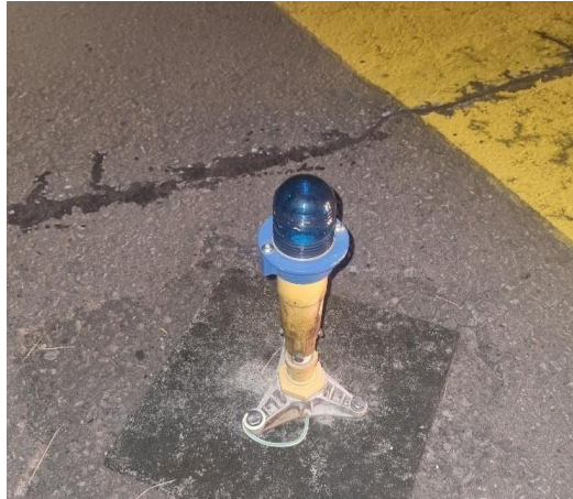
Gambar 2. 19 Taxiway Edge Lights Sumber: Dokumentasi Penulis, 2023
