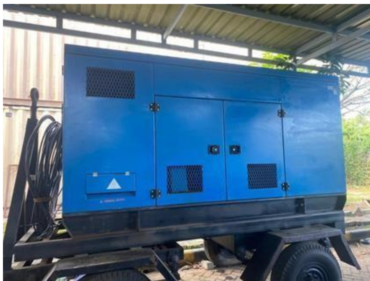
Gambar 2. 32 Genset 160 kVa Sumber: Dokumentasi Penulis, 2023
