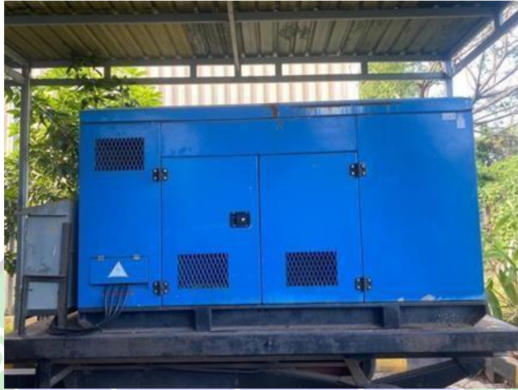
Gambar 2. 33 Genset 60 kVA Sumber: Dokumentasi Penulis, 2023
