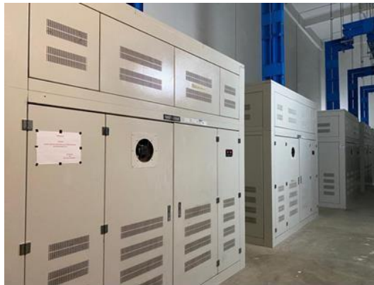
Gambar 2. 38 UPS 100 kVA Sumber: Dokumentasi Penulis, 2023
