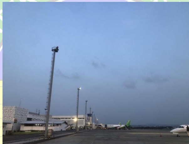
Gambar 2. 22 Apron Floodlight Sumber: Dokumentasi Penulis, 2023
