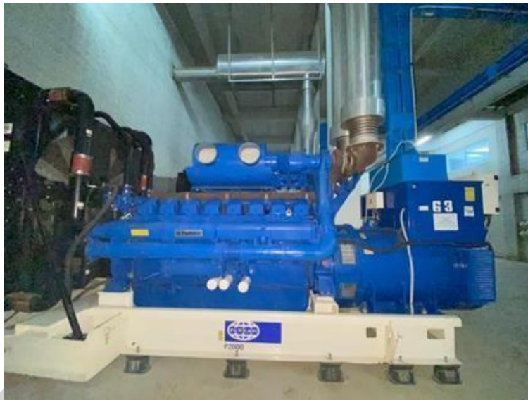
Gambar 2. 30 Genset 2000 kVA Sumber: Dokumentasi Penulis, 2023
