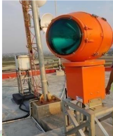
Gambar 2. 24 Rotating Beacon Sumber: Dokumentasi Penulis, 2023
