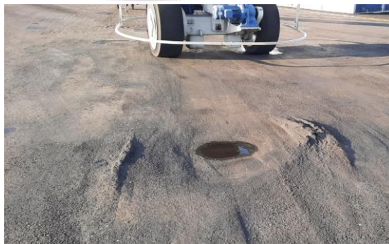
Gambar 4.14 Kondisi Kerusakan Penurunan Aspal Depression
