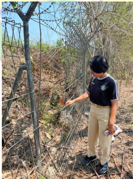
Gambar 4.23 Kerusakan pagar yang terlepas
