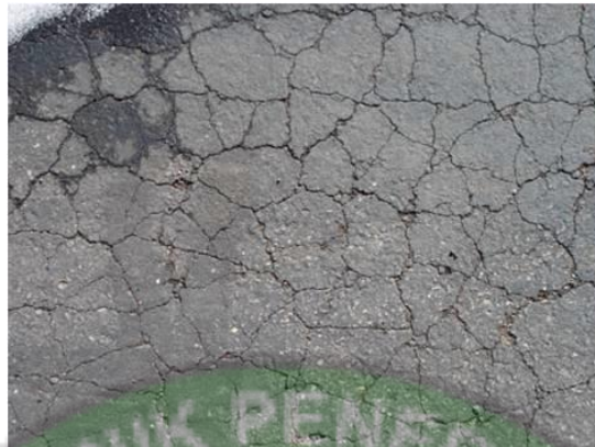
Gambar 3. 2 Retak Kulit Buaya ( Aligator Crack )
