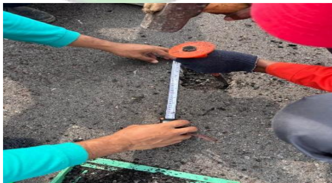
Gambar 4.21 Pengukuran area kerusakan
