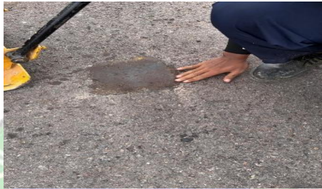
Gambar 4.29 Kondisi permukaan perkerasan setelah 20 menit
