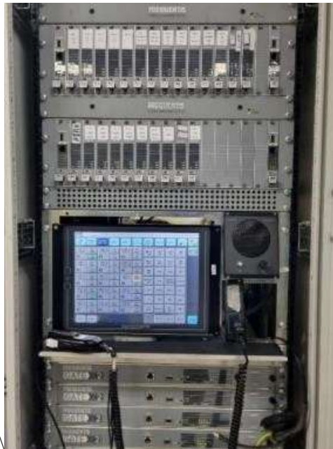
Gambar 3. 3 Server VCCS Merk FREQUENTIS Sumber : Dokumentasi Penulis
