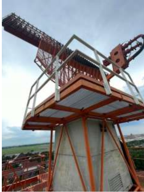
Gambar 3. 12 Antena radar Sumber: Dokumentasi Penulis 2025
