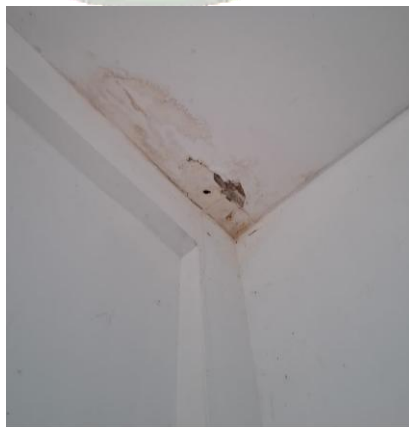
Gambar 4. 20 Kerusakan Plafon Sumber : Dokumentasi Pribadi, 2025
