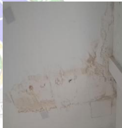
Gambar 4. 19 Kerusakan Plafon Sumber : Dokumentasi Pribadi, 2025
