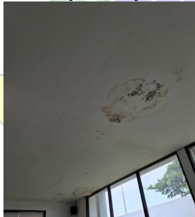
Gambar 4. 18 Kerusakan Plafon Sumber : Dokumentasi Pribadi, 2025
