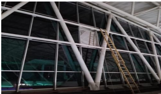
Gambar 4. 35 Pembongkaran Kaca yang Retak (Sumber: Dokumentasi Penulis, Tahun 2025)
