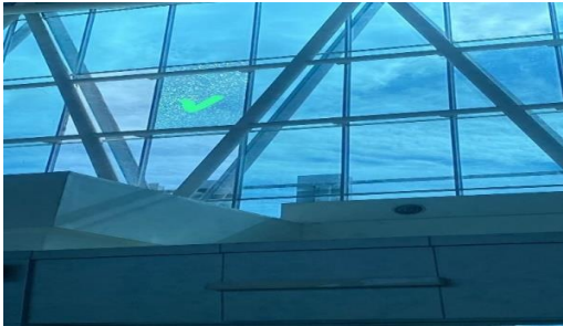
Gambar 4. 34 (Kondisi Kaca di Terminal Keberangkatan Sebeelum di Perbaiki)
