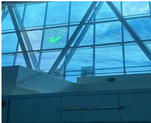
Gambar 4. 13 Retaknya Kaca Koridor Terminal (Sumber: Dokumen Penulis Tahun 2025)
