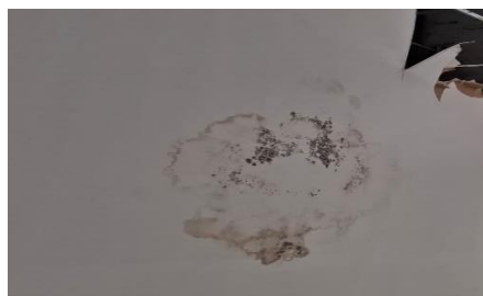
Gambar 4. 12 Dokumentasi Kerusakan Plafon di ruang SCP (Sumber: Dokumen Penulis Tahun 2025)
