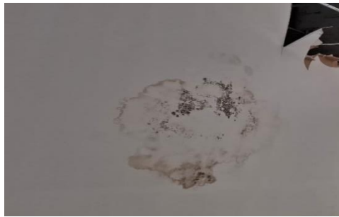
Gambar 4. 27 (Kondisi Plafon di Terminal Keberangkatan Sebelum di Perbaiki)
