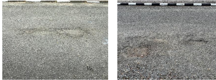
Gambar 4.2 Kerusakan jalan akses sisi darat (Sumber : Dokumentasi Pribadi,2025)
