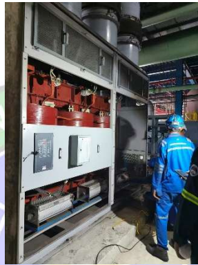
Gambar 4.2 Perawatan Trafo eksitasi
