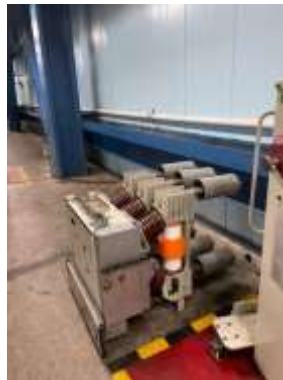
Gambar 3. 2 Komponen Switch Gear
