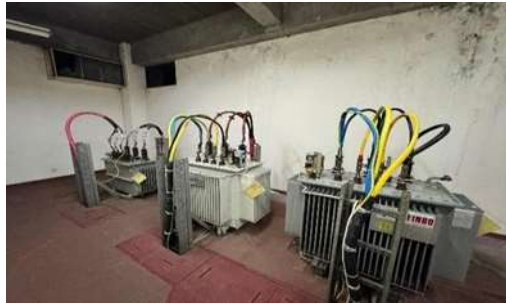
Gambar 2. 30 Trafo Garu R10
