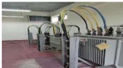
Gambar 2. 29 Trafo Gardu R28
