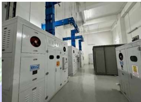
Gambar 2. 31 Trafo Genset RTT
